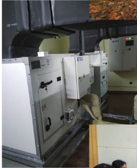
新改造恒温恒湿机房及设备
